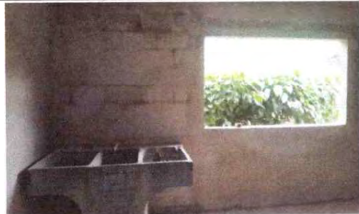
FOTO 13: REPELLO EN MURO EN MODULO DE COCINA
